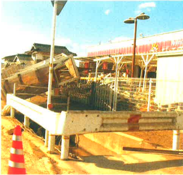
(写真は真備町のジュンテンドー付近)
